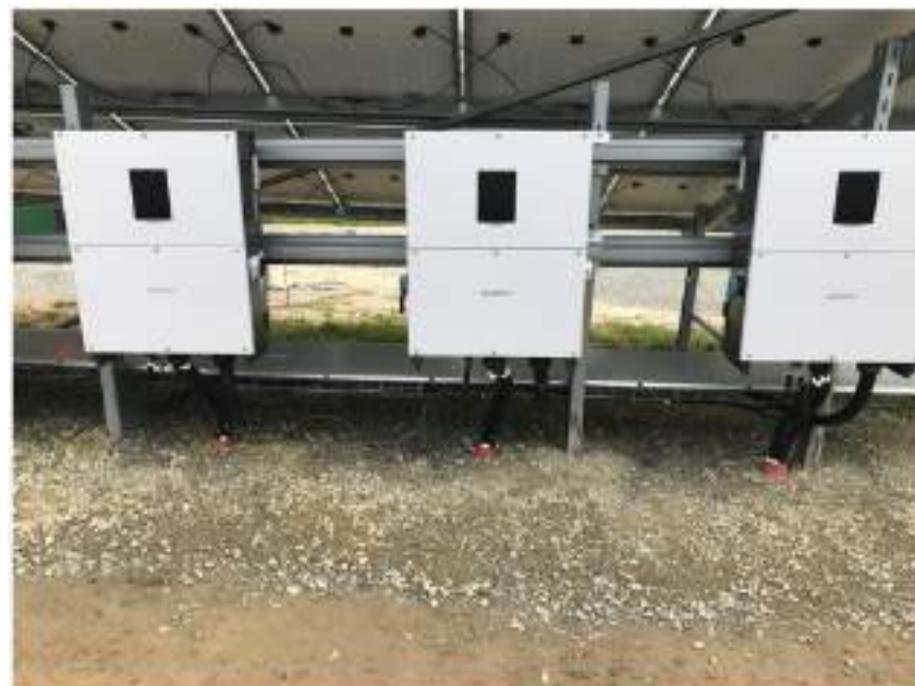
Photographie II-4: Exemple d'onduleurs strings – source CVE
